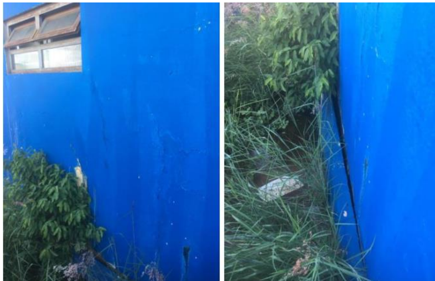
Foto 8 e 9 – Infiltrações paredes.
