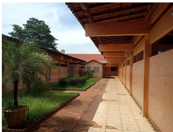
Foto 2 – Mostra área de passeio com piso danificado.
